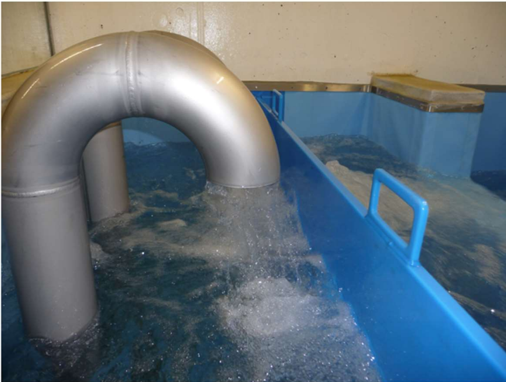
29.05.2015: Einleitung Quellen in Sammelkammer
